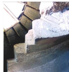
Der zerstörte Teil der Treppe hat eine Schutzabdeckung
