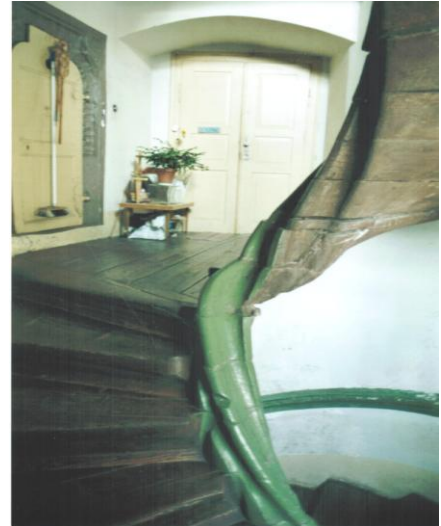
Das Podest vor der Wohnungseingangstür im 1.OG ist für die damalige Zeit ungewöhnlich groß
